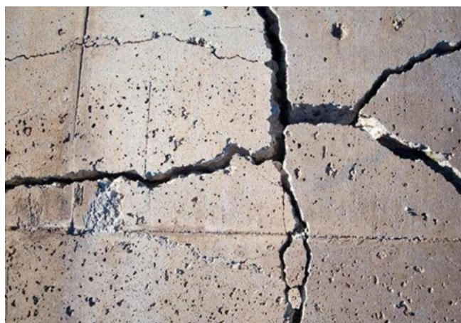
Рис. 1. Разрушение бетонной стяжки [1]
